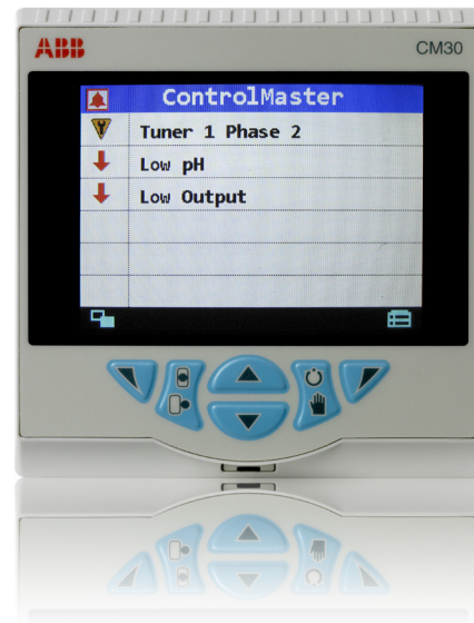
Fig. 3: Pantalla de estado de alarma
